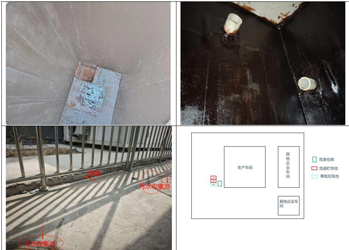
图 4-3 污水收集池内部情况及导排设施、围堰
